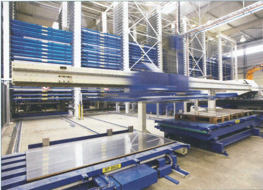
Längsseite eines Uniline-Lagersystems mit einer angebotenen Stanz-/Laser-Kombimaschine. (Bilder: Kasto)
