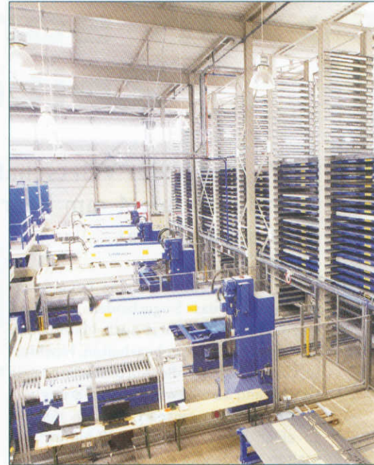
Längsseite eines Uniline-Lagersystems mit insgesamt vier übermaschinen.
