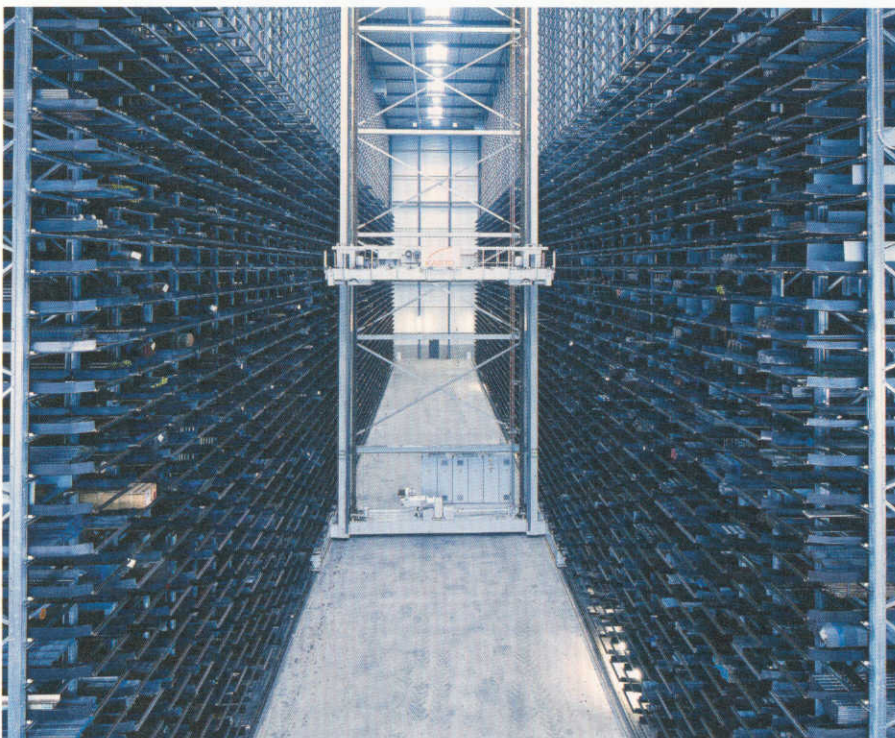
Das momentan grösste Wabenregallager der Schweiz vom Typ Unicomcompact 3.0 mit einer Höhe von 25 m.
