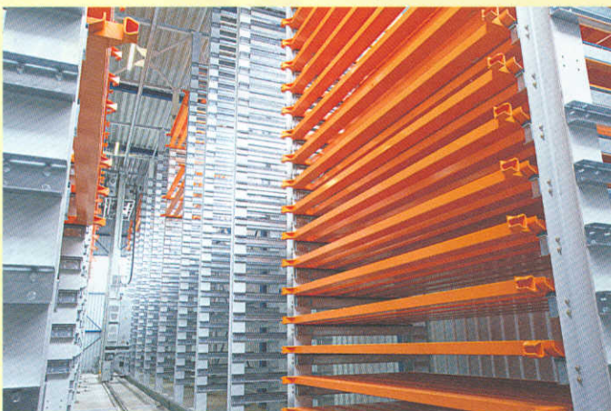
Blick in die Regalgasse des Uniline 3.0 mit dem Regalbediengerät.
